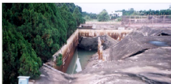
豐原第一淨水場 15,000噸清水池
