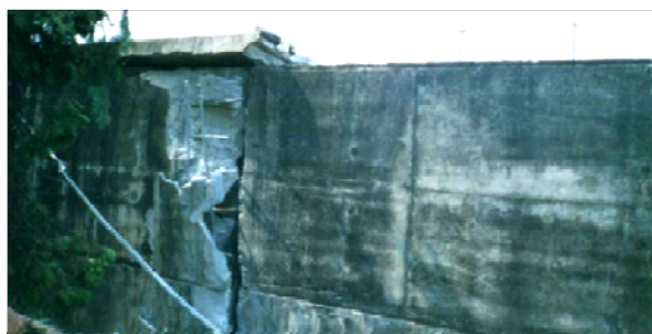
豐原第一淨水場 17,000噸清水池
